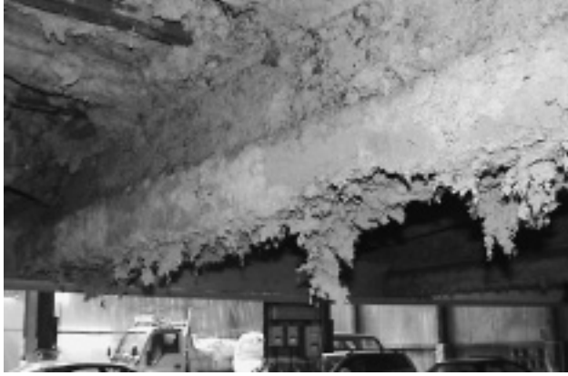
老朽化した吹き付けアスベスト（青石綿）
