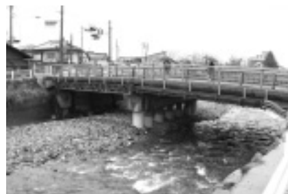
橋脚が問題とされた富士見橋
